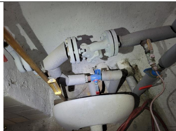
Keller, Heizungsraum (Fernwärmeanschluss), einzelne Flansche mit Asbestdichtungen
