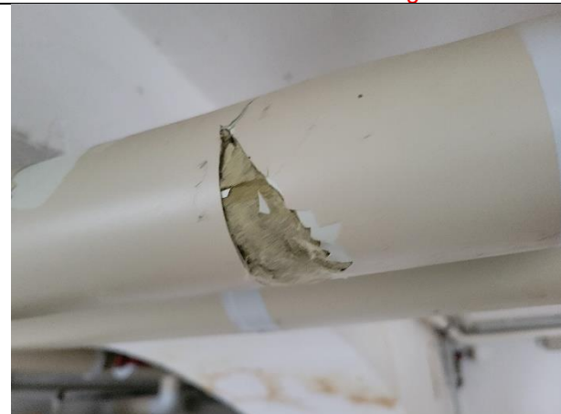
Keller, Heizungsraum, Mineralwolle um Rohrleitung
